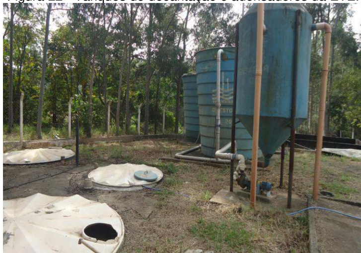
Figura 22 - Tanques de decantação e adensadores da ETE.
