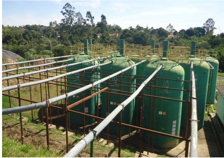
Figura 20 - Reatores Anaeróbios - ETE Cruzeiro do Sul.
