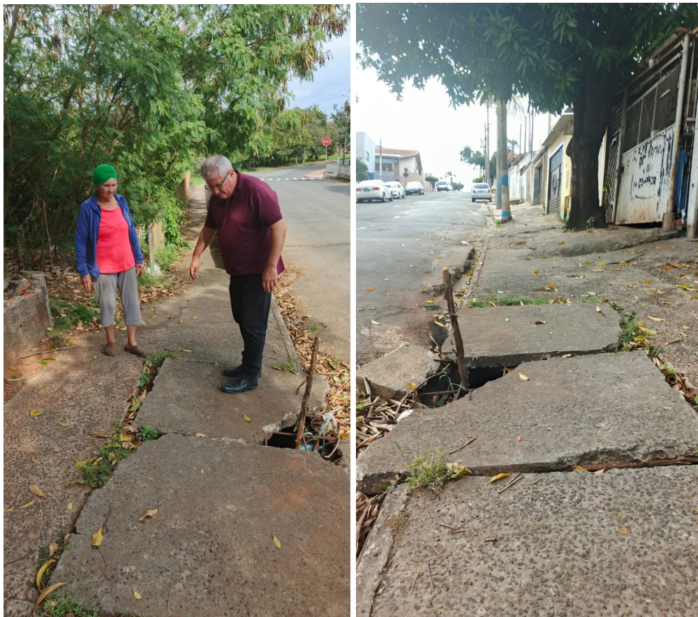
Buracos na calçada da Rua Costa Rica, na Vila Sartori.
