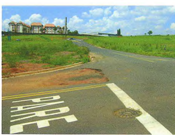
Buracos Perigosos no bairro Santa Rita.
