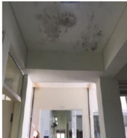
Pontos com manchas de infiltrações e vazamentos.
