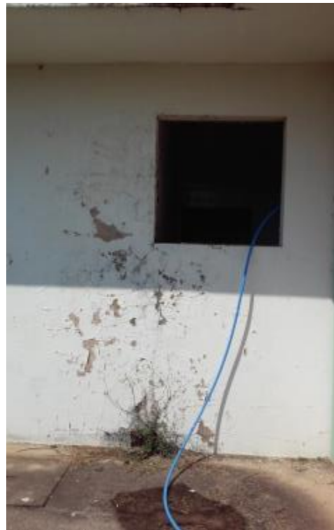
Sinais de deterioração
