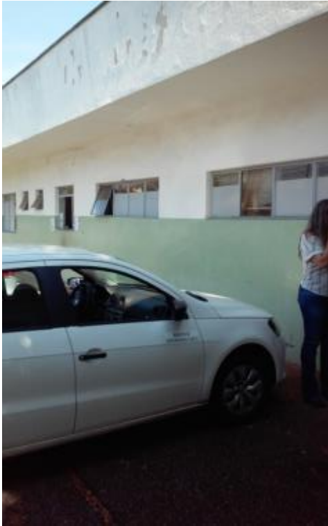
Parte externa com pintura deteriorada
