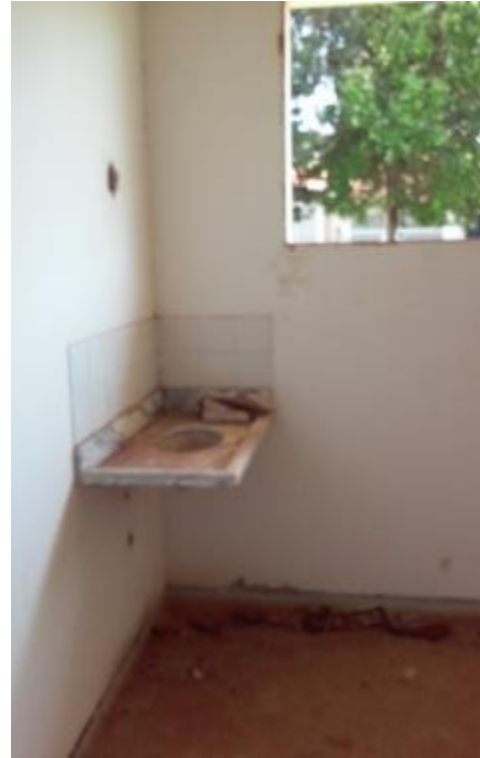
Sinais de vandalismo
