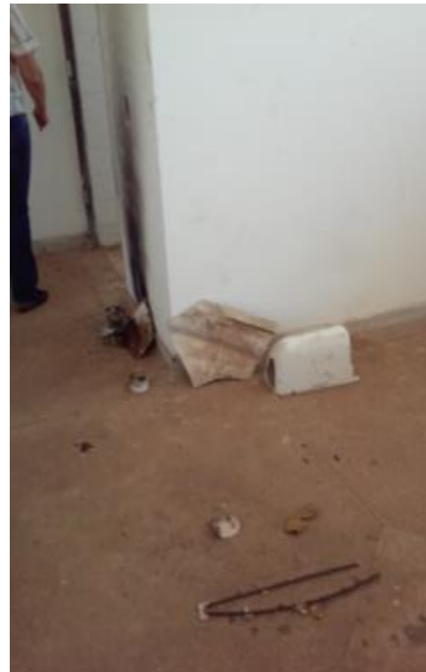
Sinais de vandalismo
