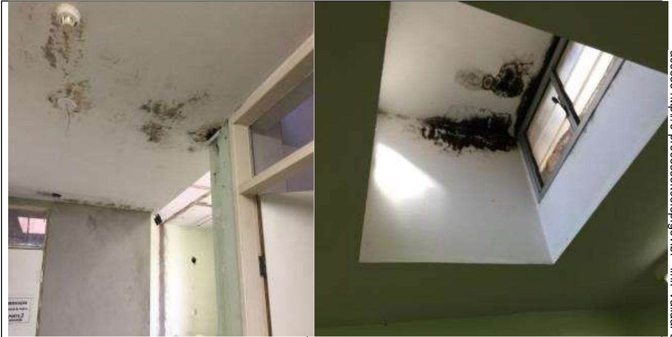
Infiltrações e vazamentos
