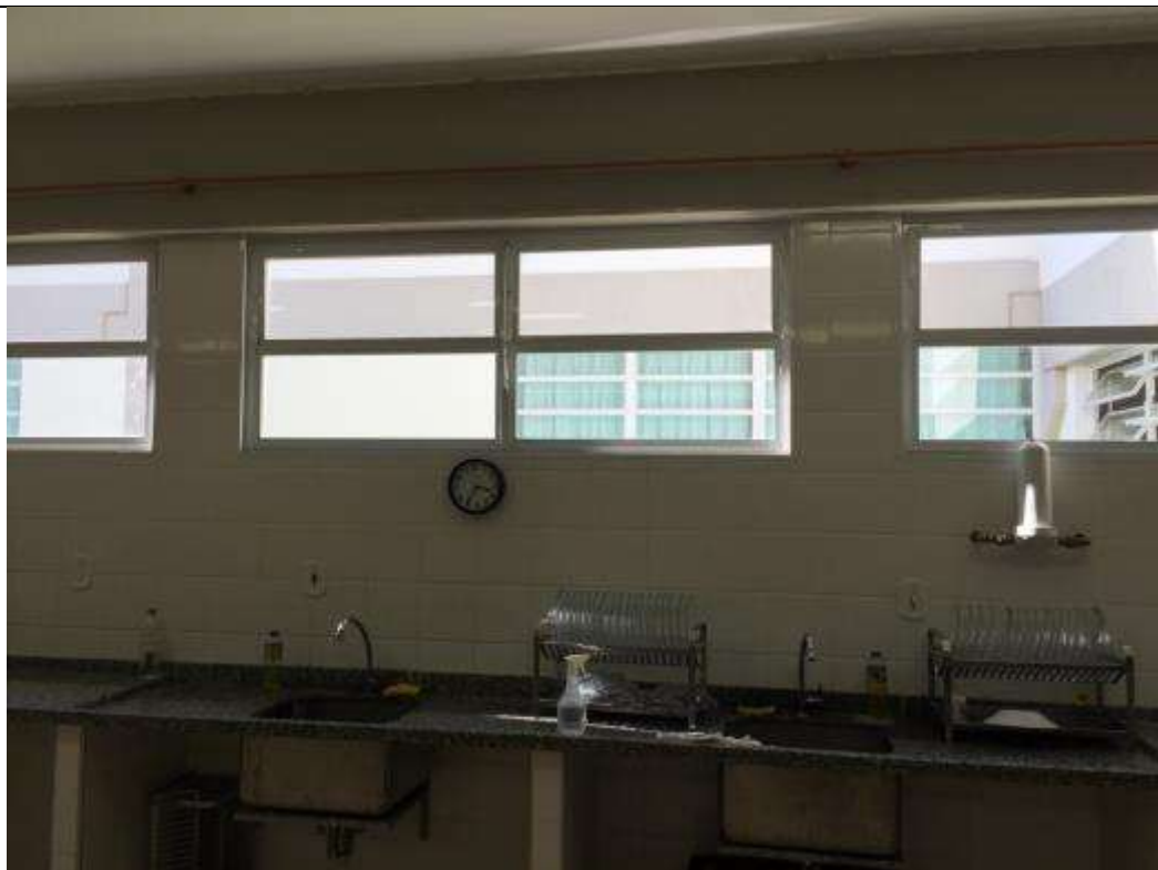
Janelas da cozinha sem as telas de proteção.
