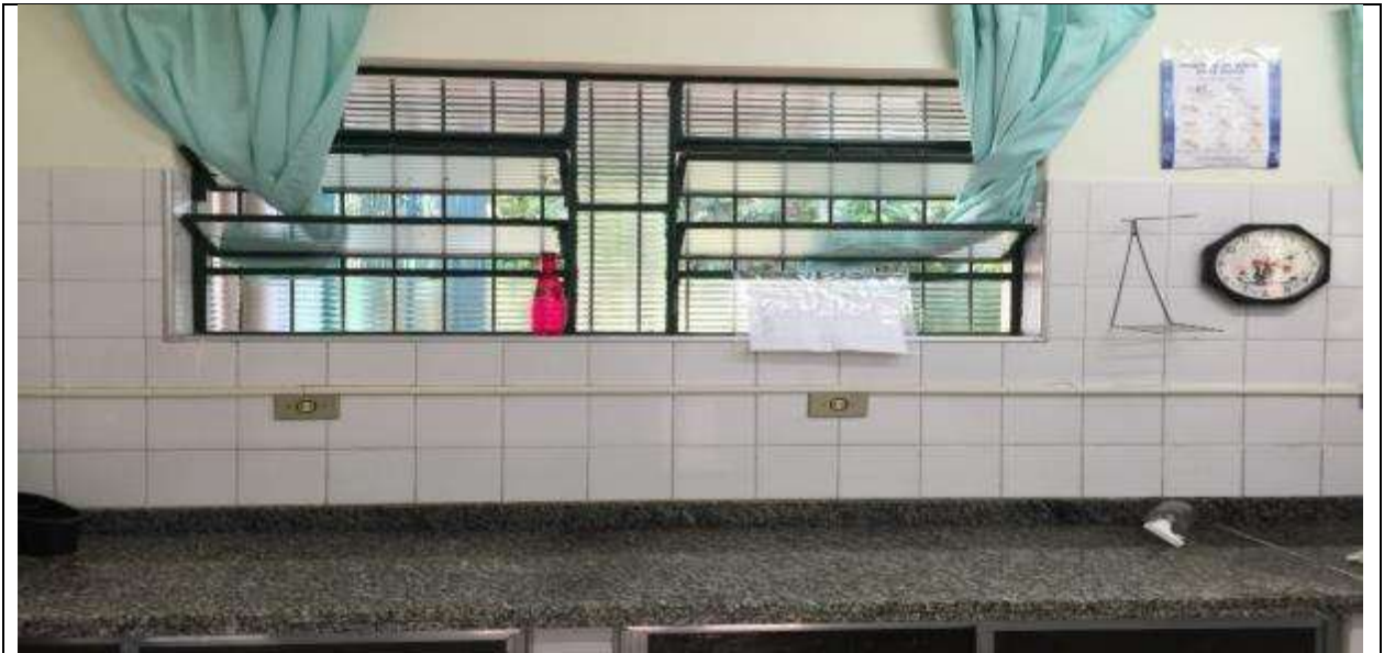
Janelas da cozinha sem as telas de proteção.
