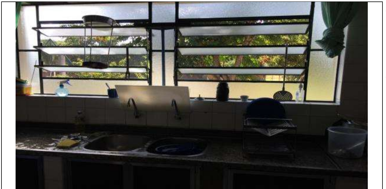
As janelas da cozinha da EMEFEI não possuem telas milimetradas.
