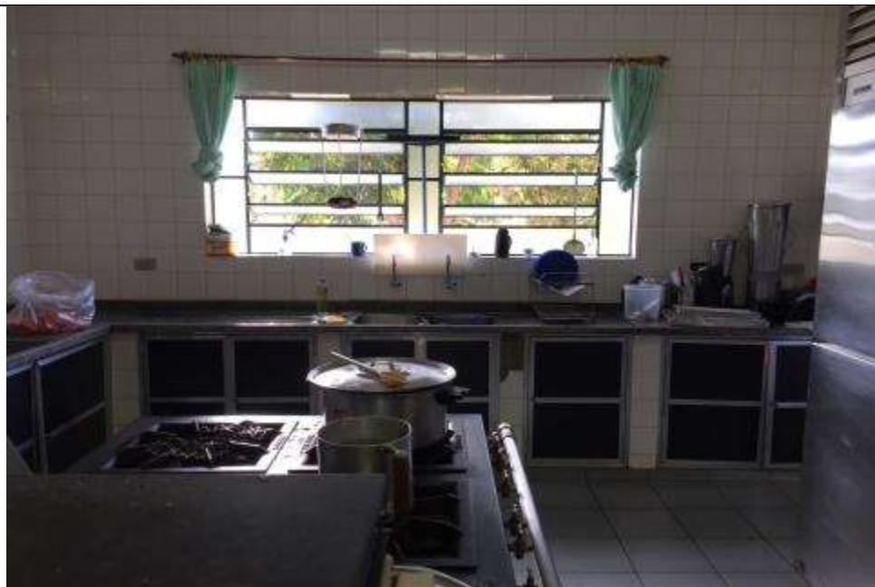
Janelas da cozinha sem as telas milimetradas de proteção.
