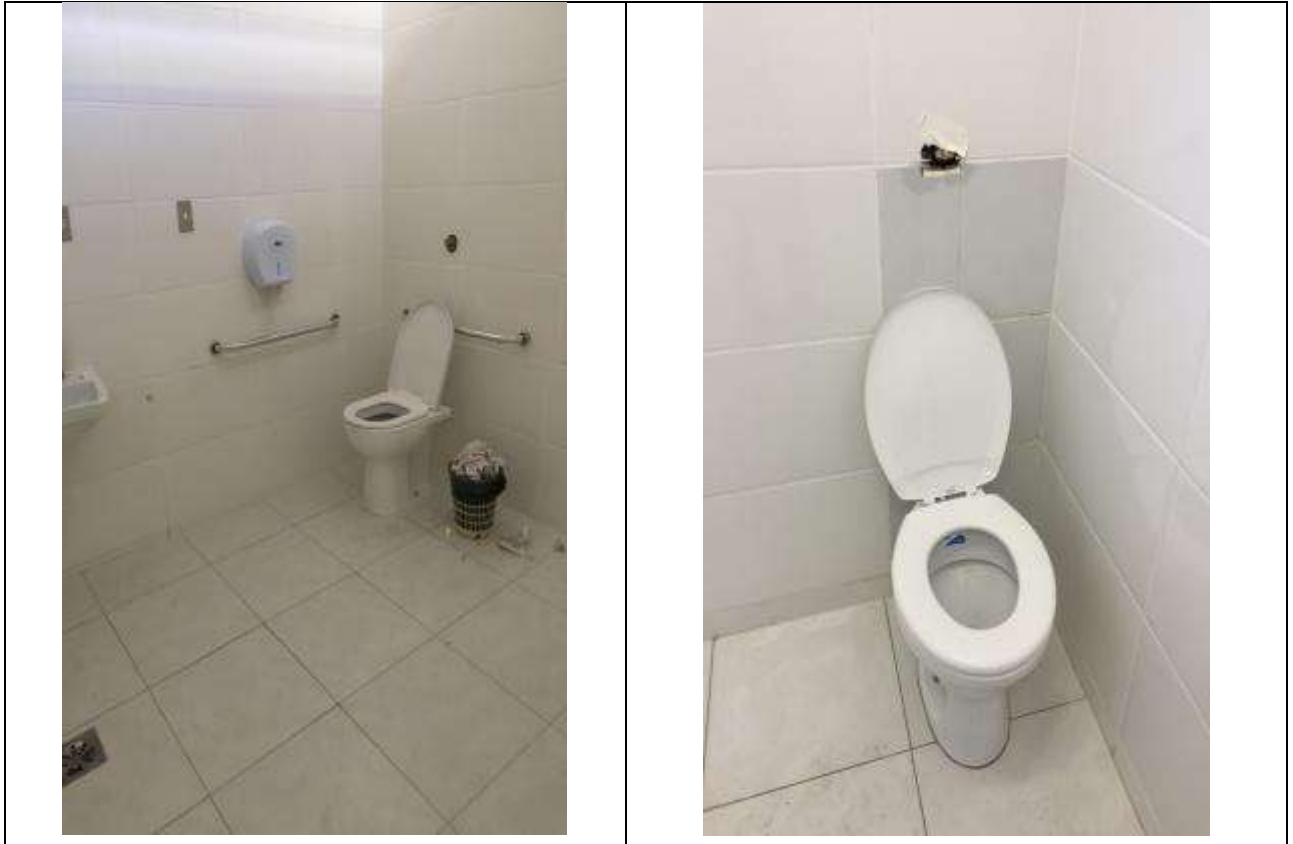
O banheiro feminino para atender o público se encontrava em condições precárias de higiene, bem como apresentava vazamento da válvula hidra no vaso sanitário.
