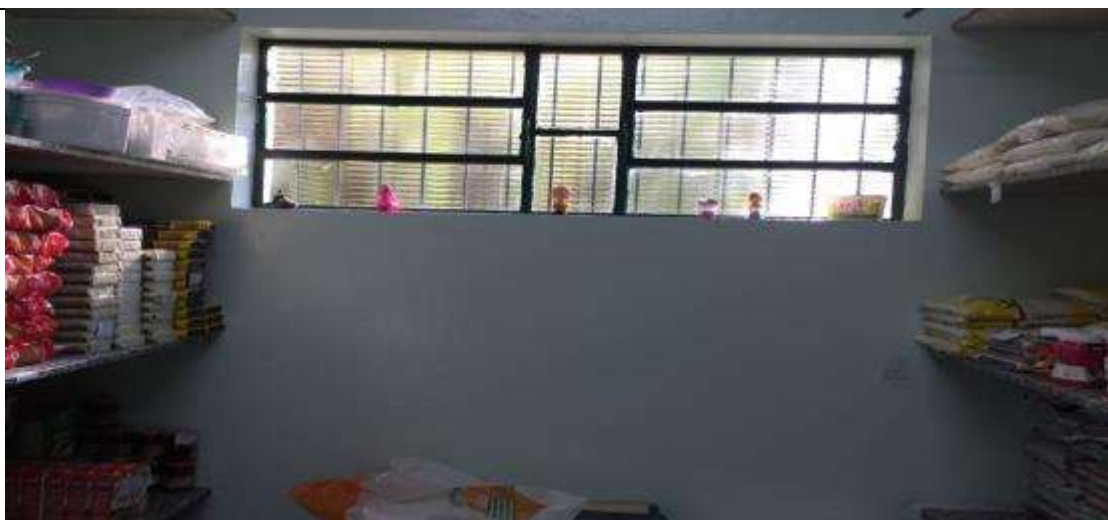
Espaço destinado ao armazenamento dos alimentos com janelas sem as telas milimetradas.
