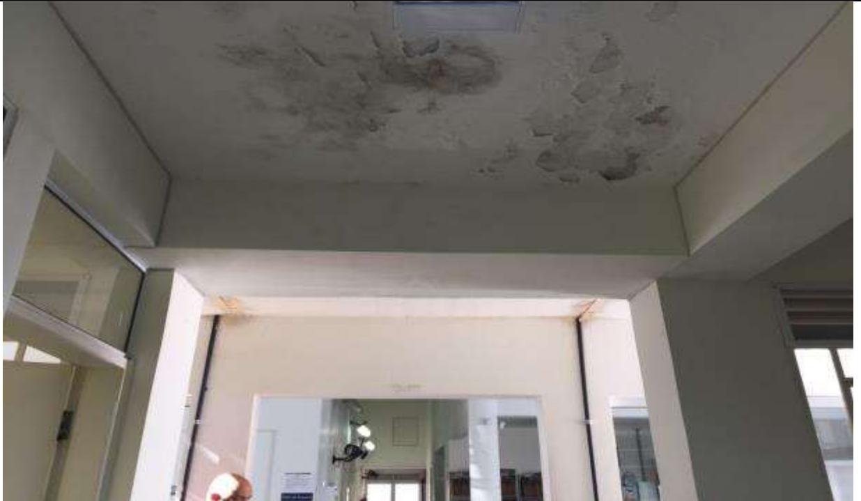
Pontos com manchas de infiltrações e vazamentos.
