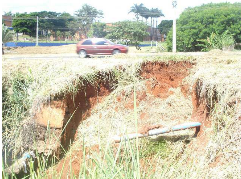
Barranco desmoronando, no córrego Giovanetti, próximo a Avenida Santa Bárbara.
