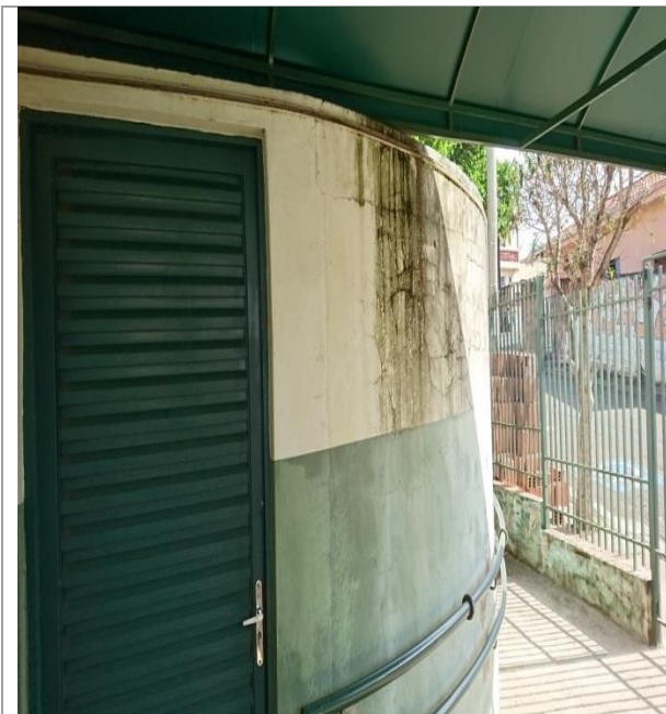
Necessidade de Pintura externa
