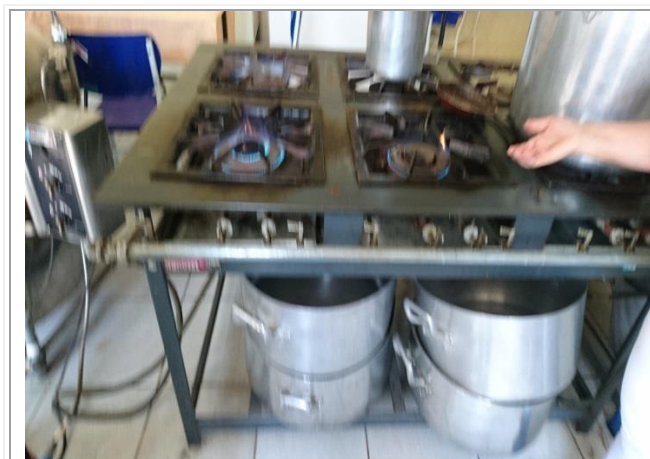
Vazamento de Gás a corrigir
