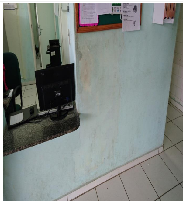
Necessidade de Pintura Interna
