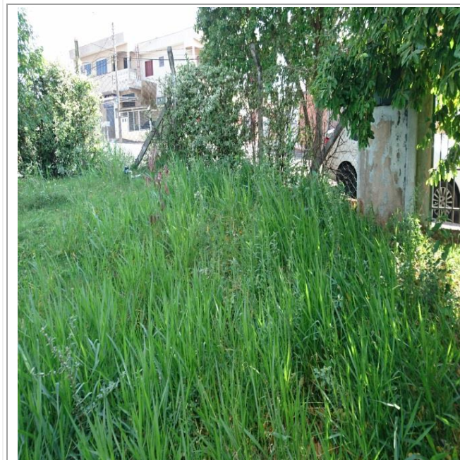
Necessidade de Roçagem da grama
