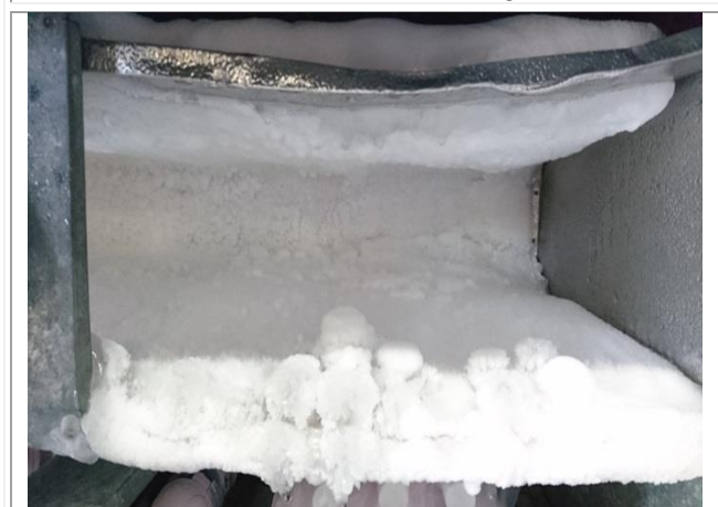
Refrigerador: funcionamento irregular
