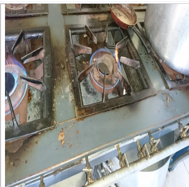
Vazamento de Gás a corrigir
