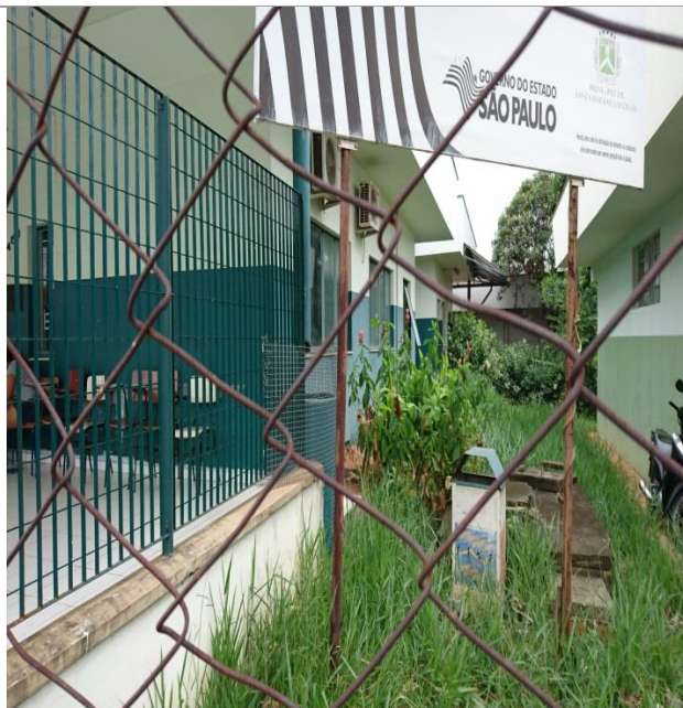
Necessidade de Limpeza Externa e Roçagem de Grama
