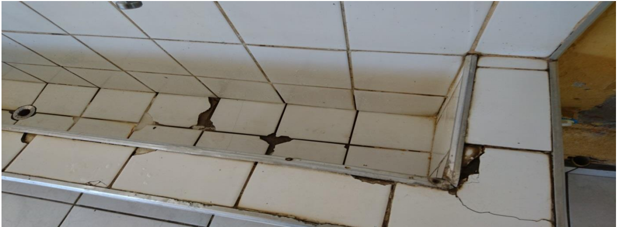
Bebedouro coletivo – necessidade de reforma
