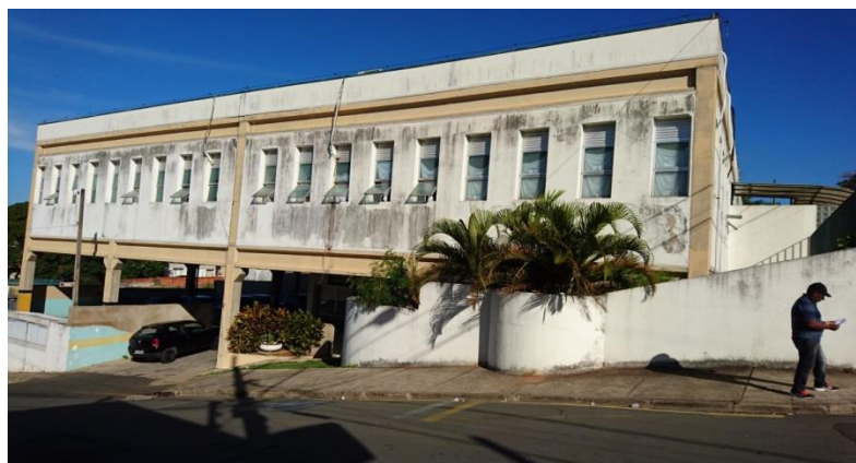
Necessidade de pintura externa
