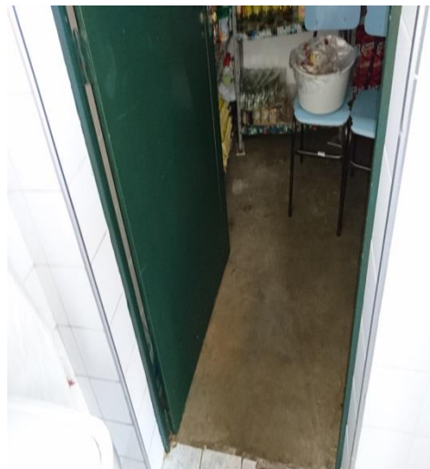
Guarda de alimentos: espaço insuficiente
