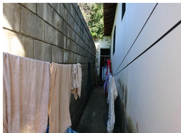
Necessidade de pintura/adequação
