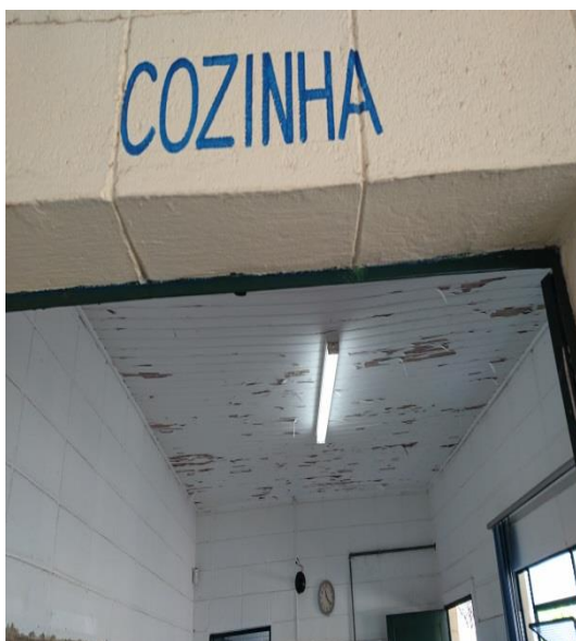
Forro necessita de reforma
