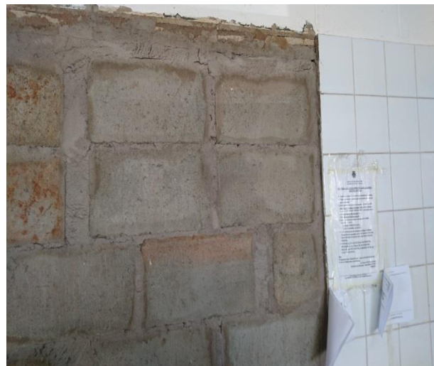
Falta de azulejos
