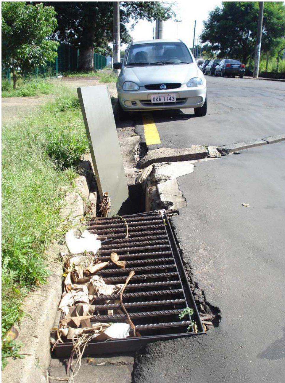
Bueiro danificado na Rua do César, próximo ao portão do Tivoli Shopping, no bairro Mollon.
