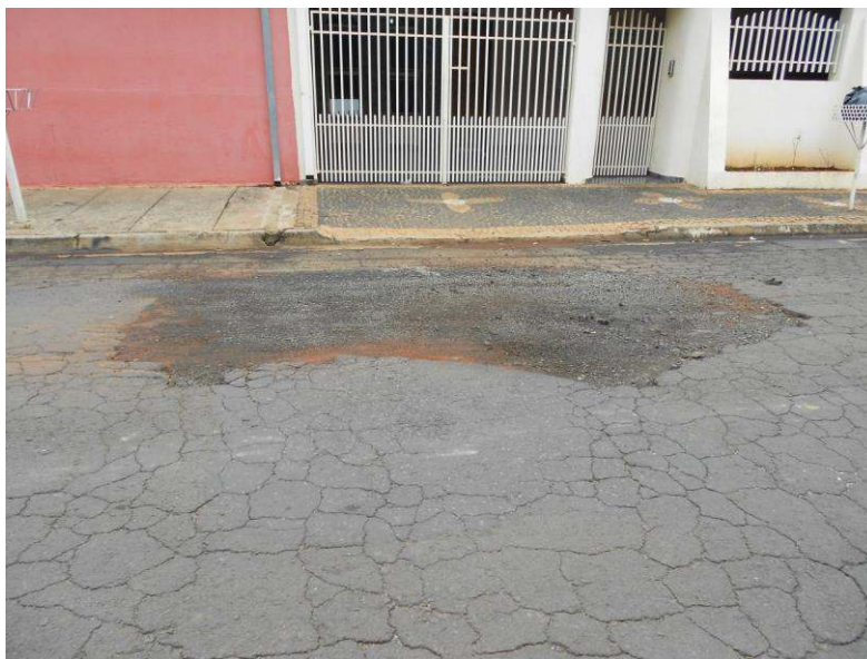
Buraco na Rua Caconde, 86 – bairro São Joaquim
