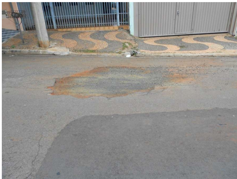
Buraco na Rua Teresina , próximo ao nº 945, Bairro Planalto do Sol
