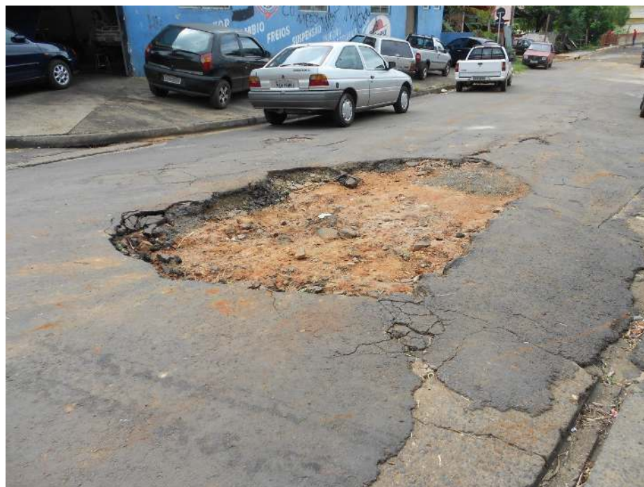
Buraco localizado na Av. Cabreúva esquina com a Rua João Pedroso, no bairro Vila Lola.
