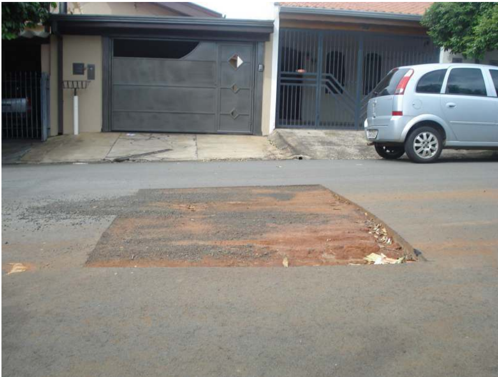
Buraco na Rua Miguel Tunussi, defronte aos números 621 e 615, no bairro Mollon IV
