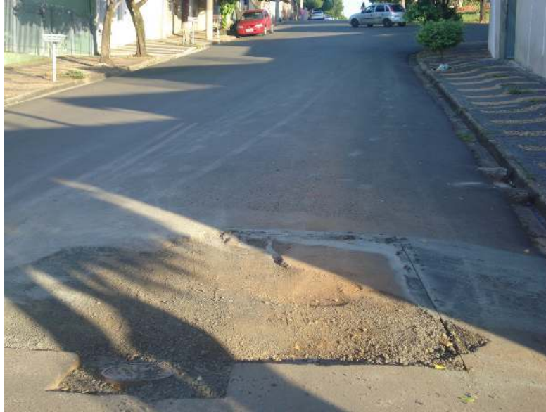
Buraco na Rua Marília de Dirceu, próximo ao número 64, no Parque Olaria.
