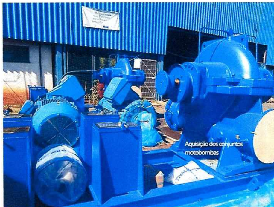
Figura 12 - Novos Conjuntos Moto Bomba
