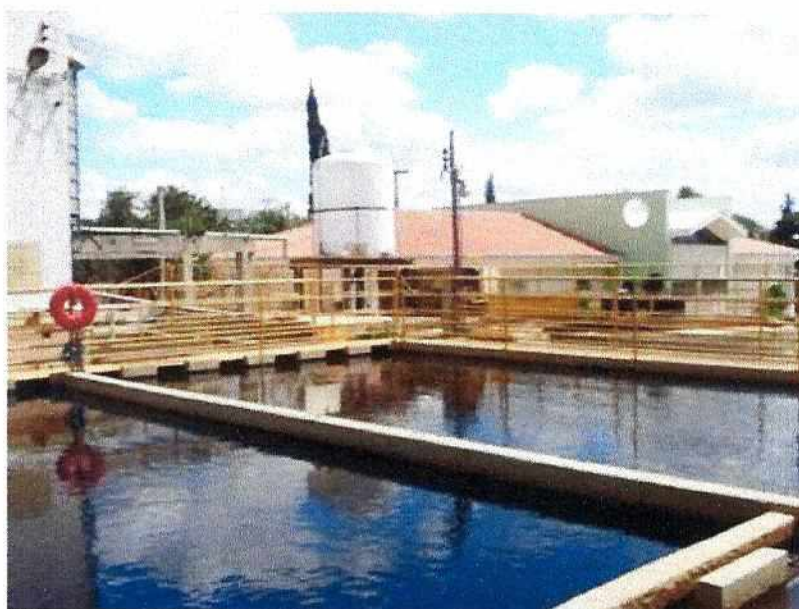
Figura 14 - Tanques de decantação ETA I
