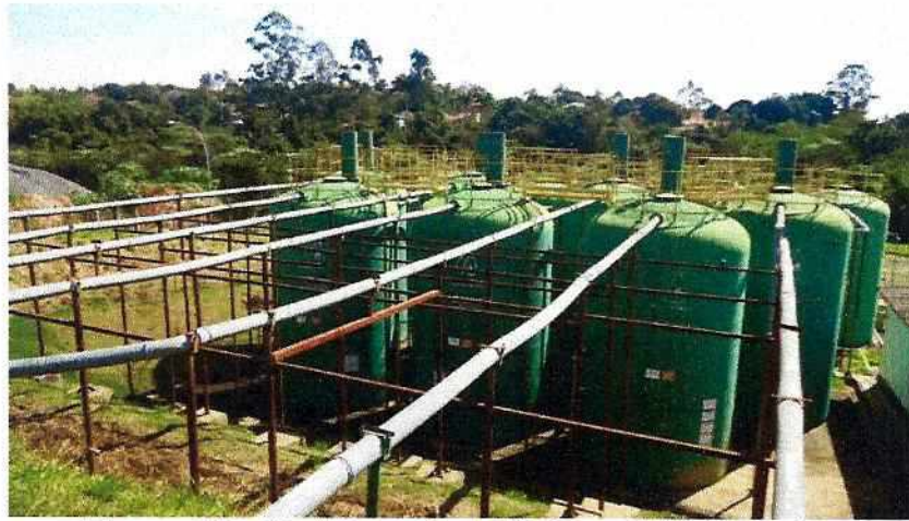
Figura 30 - Reatores Anaeróbios - ETE Cruzeiro do Sul.
