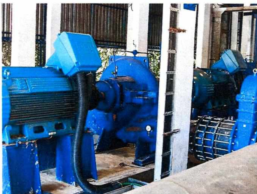
Figura 11 - Novos Equipamentos EEAB Santa Alice
