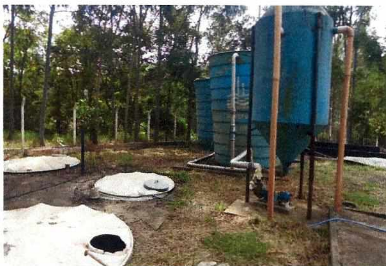
Figura 32 - Tanques de decantação e adensadores da ETE Nova Conquista.
