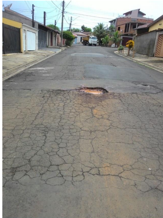
Buraco na Extensão da rua iporanga
