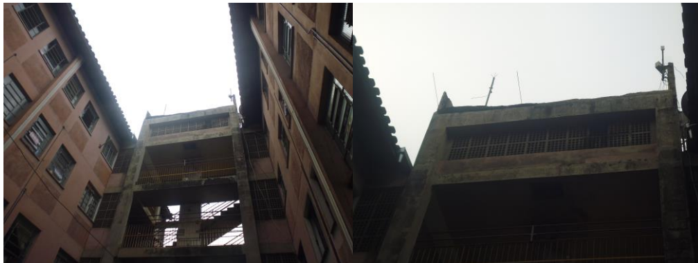
Parede lateral da caixa de água do Bloco 75 que já caiu devido avarias com o decorrer do tempo.
