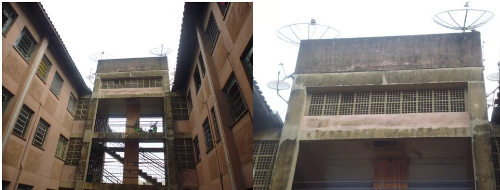
Parede lateral da caixa de água do Bloco 140 que houve avarias com o decorrer do tempo e está balançando.
