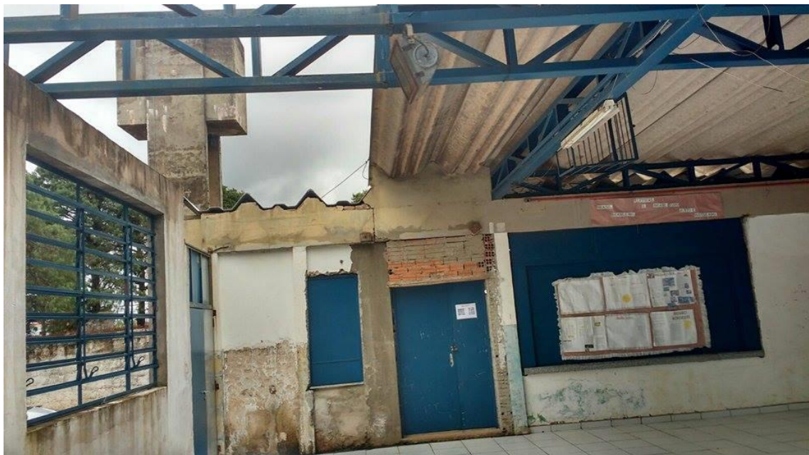
Cozinha destelhada há mais de um ano. Empresa que estava realizando abandonou a obra.
