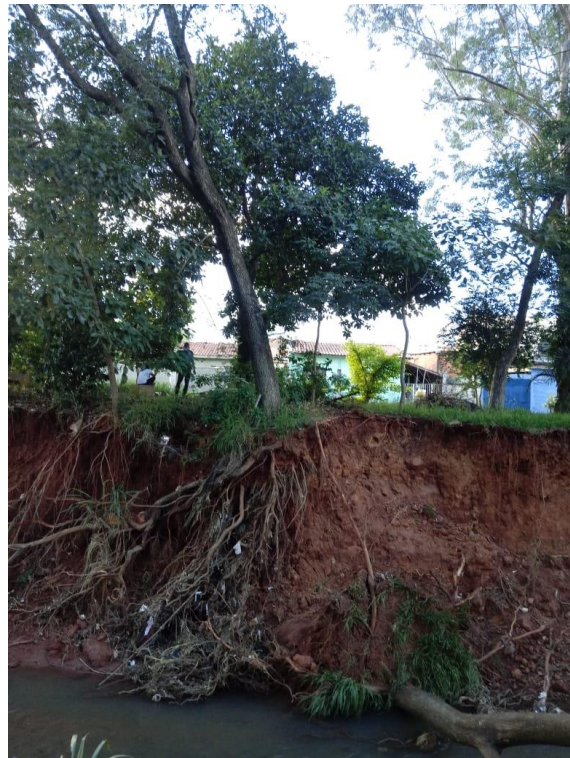
EROSÃO DO CÓRREGO - 2019
