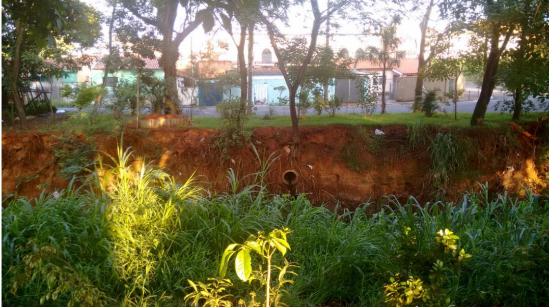
EROSÃO DO CÓRREGO - 2015
