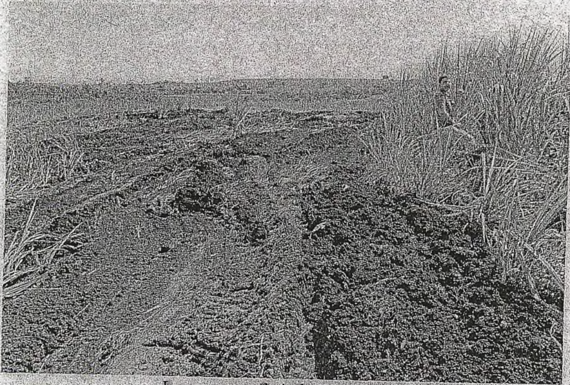
Lançamento de lodo no canal
