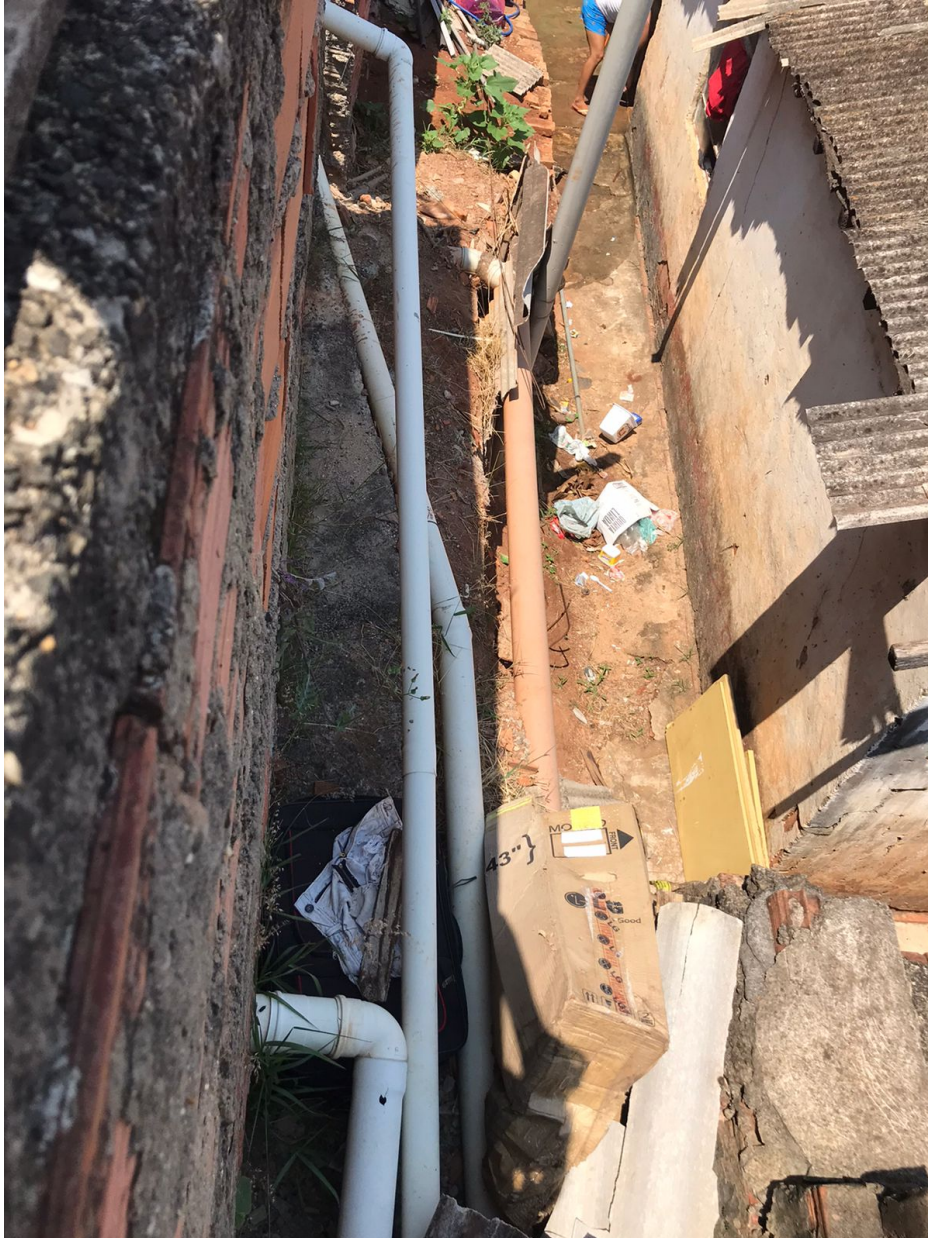
Viela exposta, na residência localizada na Rua Finlândia 350 – Jardim Europa.
